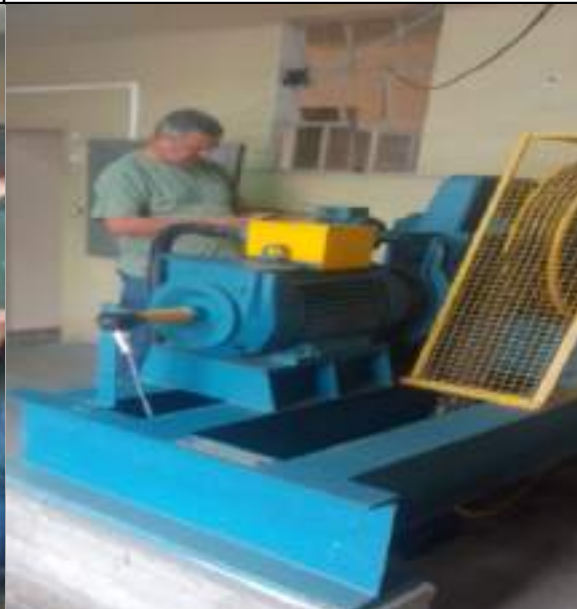
FOTO 12: Adequação da infraestrutura de alimentação elétrica para implantação do CPD.
