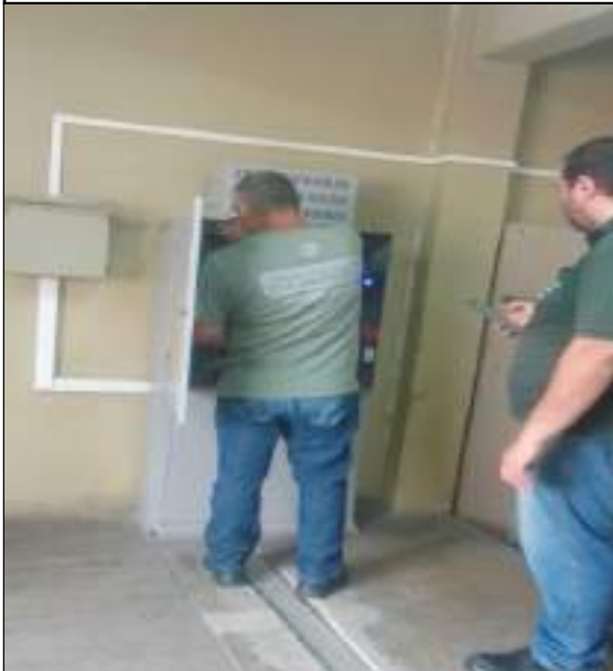
FOTO 11: Adequação da infraestrutura de alimentação elétrica para implantação do CPD.
