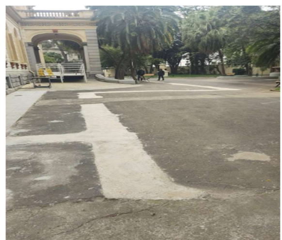
FOTO 103: Conservação revestimento externo de circulação, revestimento com elemento de demarcação, pintura e correção viária.
