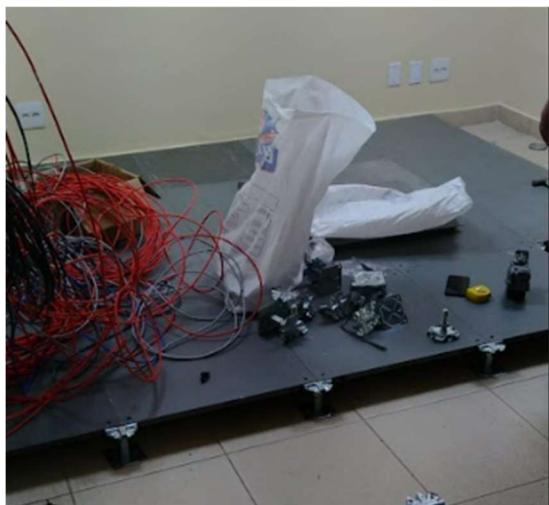
FOTO 93: Implantação CPD, piso sobreposto elevado.
