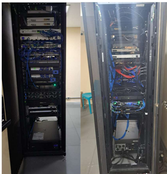
FOTO 97: Implantação CPD, rack de ativos de rede.
