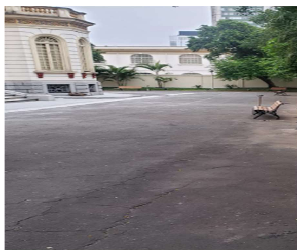
FOTO 104: Conservação revestimento externo de circulação, revestimento com elemento de demarcação, pintura e correção viária.
