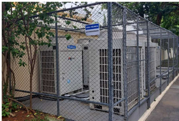
FOTO 117: Manutenção de salas técnicas, revisão da proteção mecânica e pintura, sala equipamentos de climatização para troca externa.
