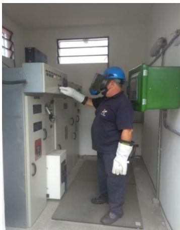
Automatização da cabine primária
