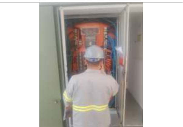
Vistoria da cabine primária (Mensal)
