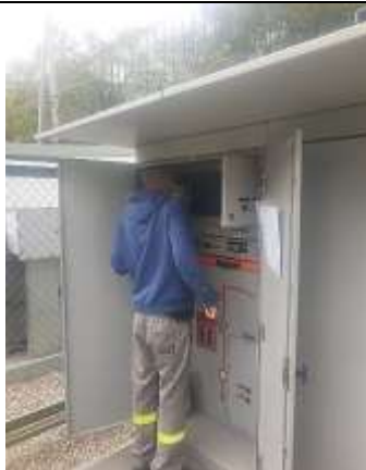
Vistoria da cabine primária (Mensal)
