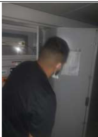
Manutenção Anual – Cabine primária
