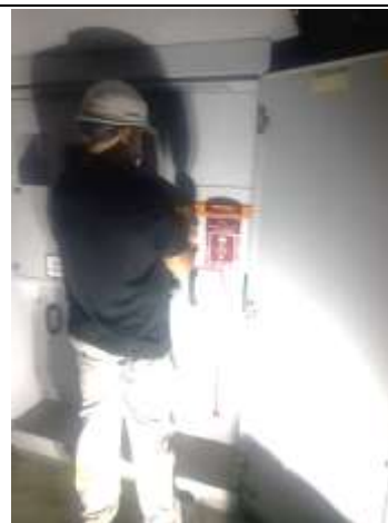
Finalização - Manutenção anual da cabine primária
