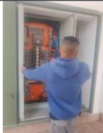
Vistoria da cabine primária (Mensal)
