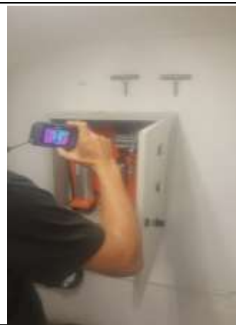
Vistoria da cabine primária (Mensal)
