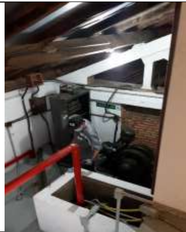
Manutenção preventiva do Elevador (Mensal)
