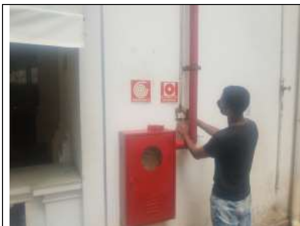
Manutenção Preventiva – Central de alarme de Incêndio (Mensal)
