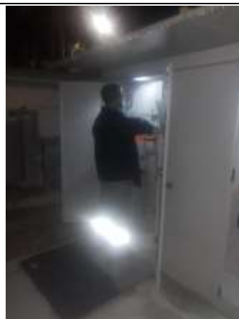
Manutenção Anual – Cabine primária
