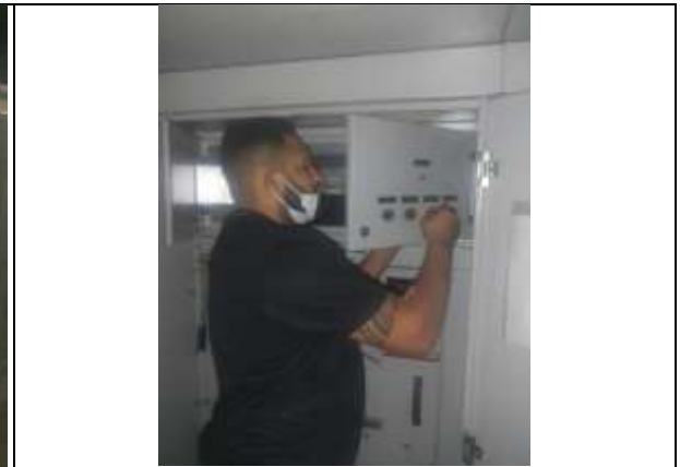
Manutenção Anual – Cabine primária
