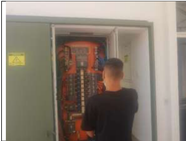
Vistoria da cabine primária (Mensal)
