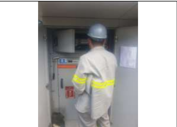
Vistoria da cabine primária (Mensal)
