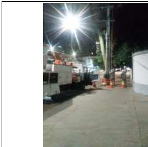
Finalização - Manutenção anual da cabine primária
