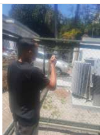
Vistoria da cabine primária (Mensal)
