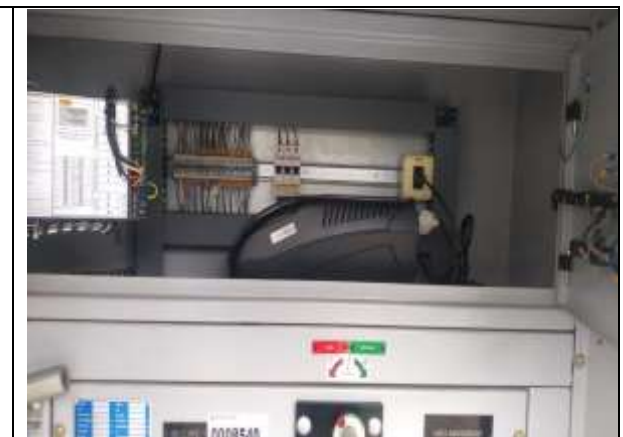
Substituição de nobreak da cabine primária
