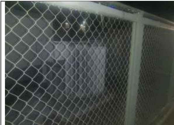
Manutenção Anual – Cabine primária
