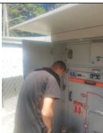
Vistoria da cabine primária (Mensal)
