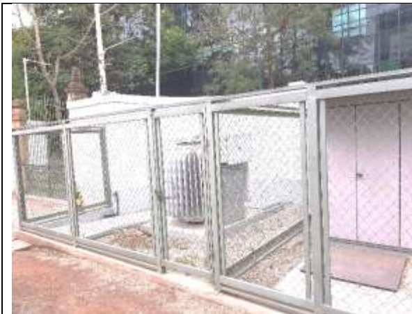
Vistoria da cabine primária (Mensal)
