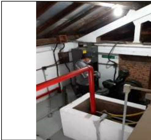
Manutenção preventiva do Elevador (Mensal)
