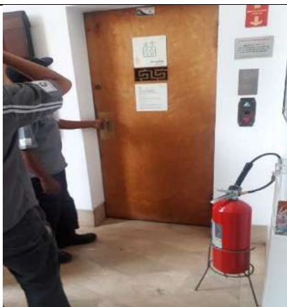
Manutenção Preventiva do Elevador (mensal)
