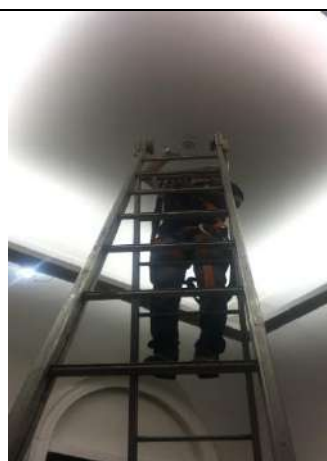
Manutenção Preventiva – Central de alarme de incêndios (mensal)
