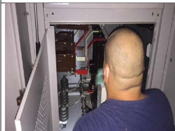
Manutenção Anual da Cabine primária
