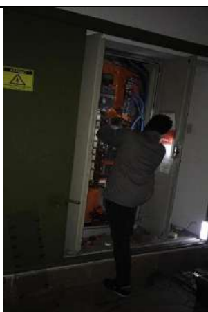
Manutenção Anual da Cabine primária
