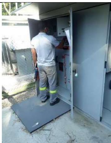
Vistoria – Cabine primária (mensal)
