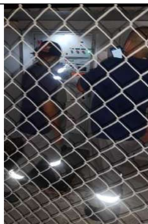
Manutenção Anual da Cabine primária
