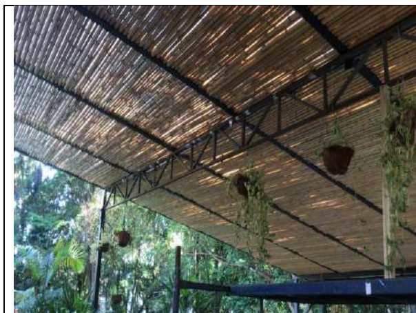
Instalação de forro de bambu do deck do restaurante e reforço na estrutura.
