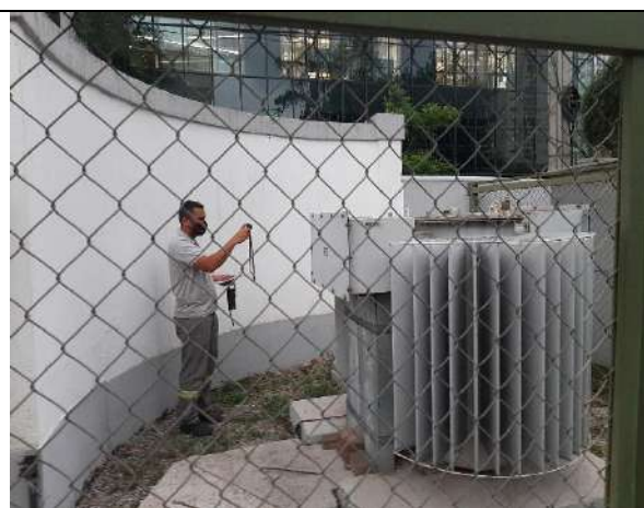
Vistoria – Cabine primária (mensal)
