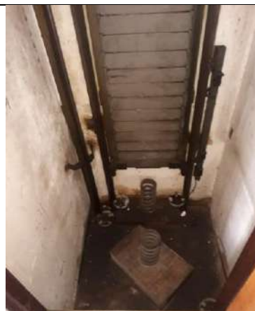
Manutenção Preventiva do Elevador (mensal)
