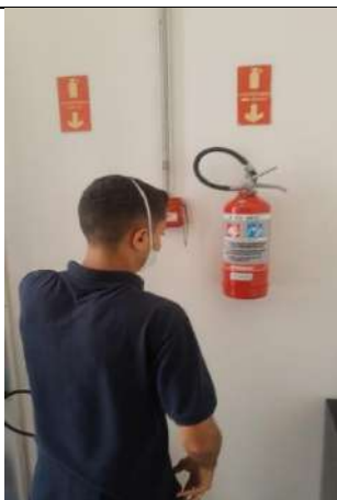
Manutenção Preventiva – Central de alarme de incêndios (mensal)
