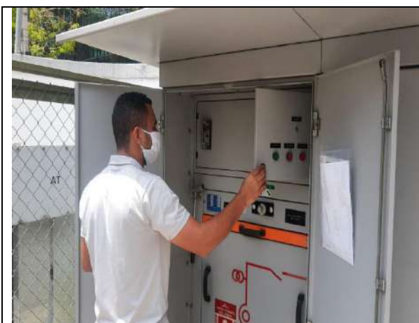
Vistoria – Cabine primária (mensal)
