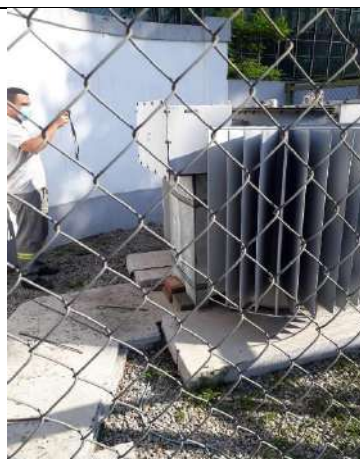
Vistoria – Cabine primária (mensal)
