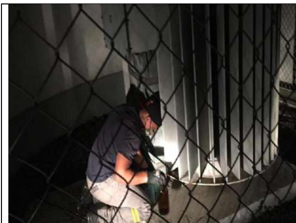
Manutenção Anual da Cabine primária
