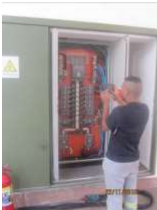
Manutenção mensal da Cabine Primária (nov)
