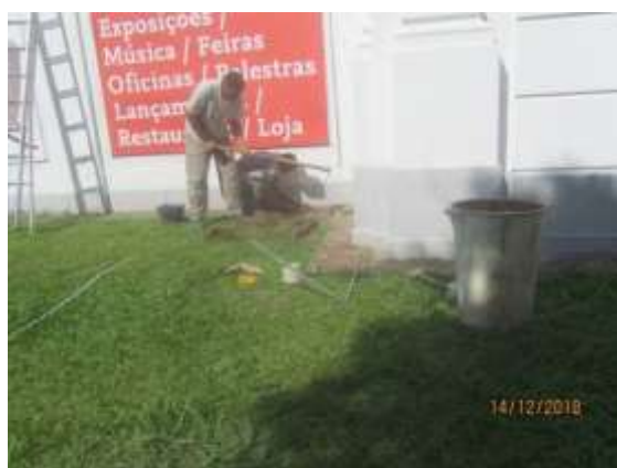
Manutenção Para-raios (dez)
