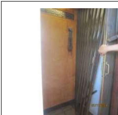
Registro de danos na porta pantográfica do elevador (nov).
