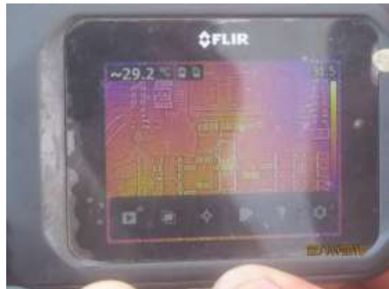
Manutenção mensal da Cabine Primária (nov)
