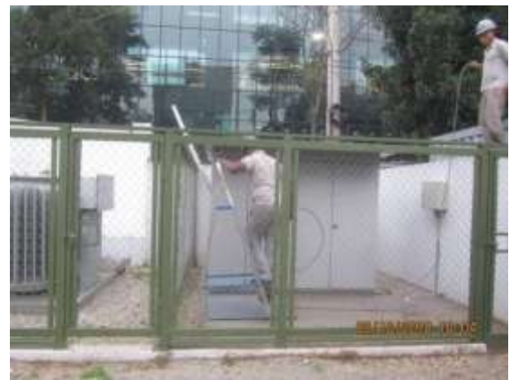
Manutenção / Limpeza Cabine Primária (out)
