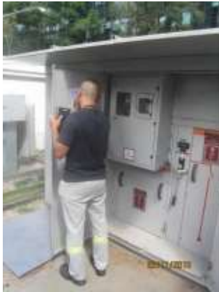
Manutenção mensal da Cabine Primária (nov)
