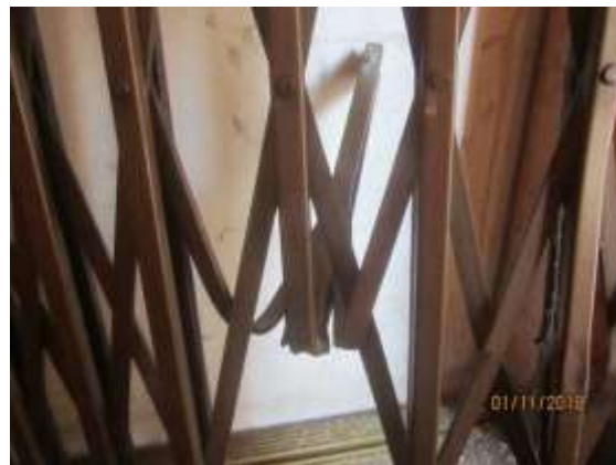
Registro de danos na porta pantográfica do elevador (nov).
