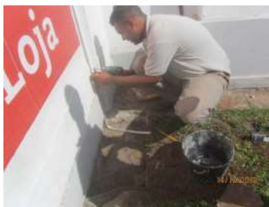
Manutenção Para-raios (dez)
