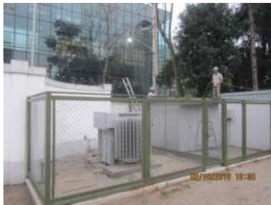
Manutenção / Limpeza Cabine Primária (out)
