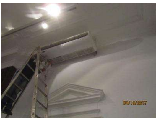
Manutenção Ar Condicionado – Evaporadora Crespi Prado (out)
