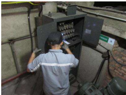
Manutenção preventiva mensal do elevador (out)
