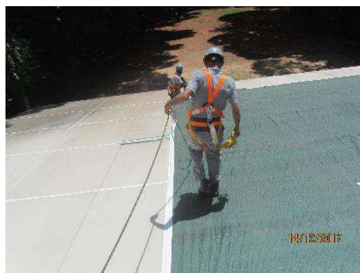
Manutenção do toldo do terraço com vários pontos de goteira (dez)
