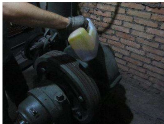
Manutenção preventiva mensal do elevador (out)
