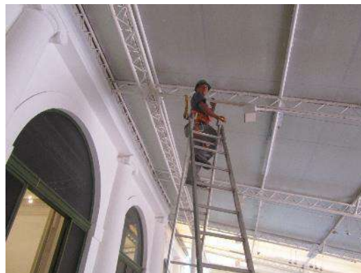
Manutenção do toldo do terraço com vários pontos de goteira (out)
