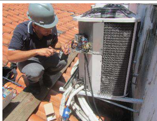
Manutenção Ar Condicionado – Condensadora Crespi Prado (out)
