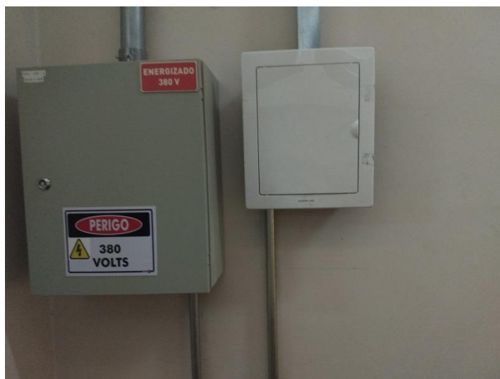
Quadro principal e parcial dos disjuntores
