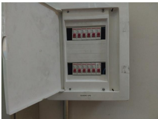
Quadro parcial dos disjuntores
