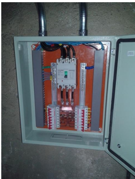
Painel elétrico dos ar condicionados
