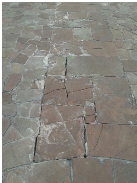
Piso solto devido a passagens de ônibus
