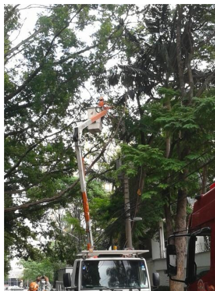
Retirada da árvore da fiação pela AES Eletropaulo
