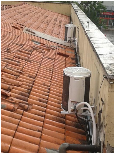
Instalação externa dos aparelhos do CEDOC
