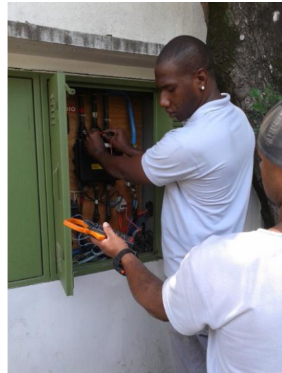
Inspeção da cabine primária
