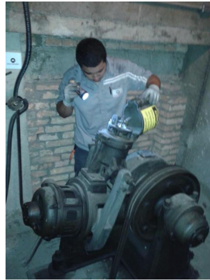
Manutenção preventiva da mecânica do elevador
