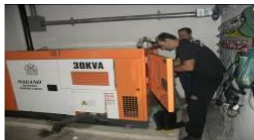
Foto 02 – MANUTENÇÃO PREVENTIVA DO GERADOR
