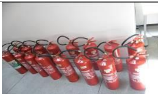
Foto 01 Recarga de 28 extintores
